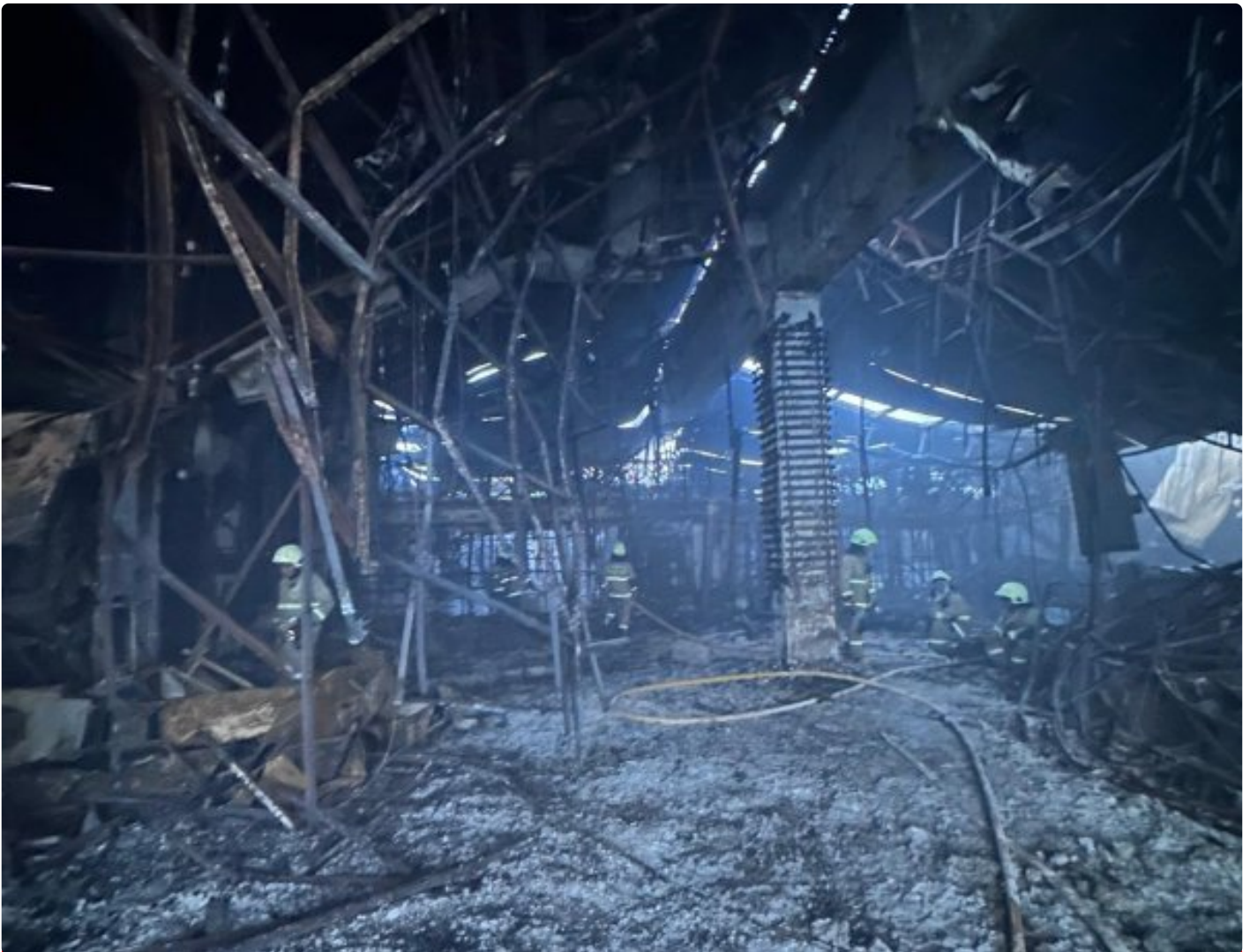
Glodok Plaza yang Hangus Terbakar
